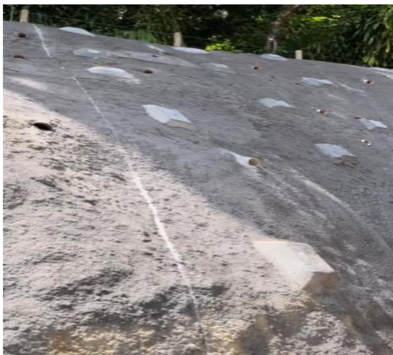
Figura 2 Encosta rodoviária da cidade de cachoeira BA
